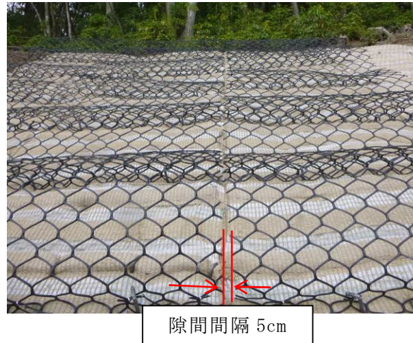
写真-18. アーチブロックの隙間間隔
